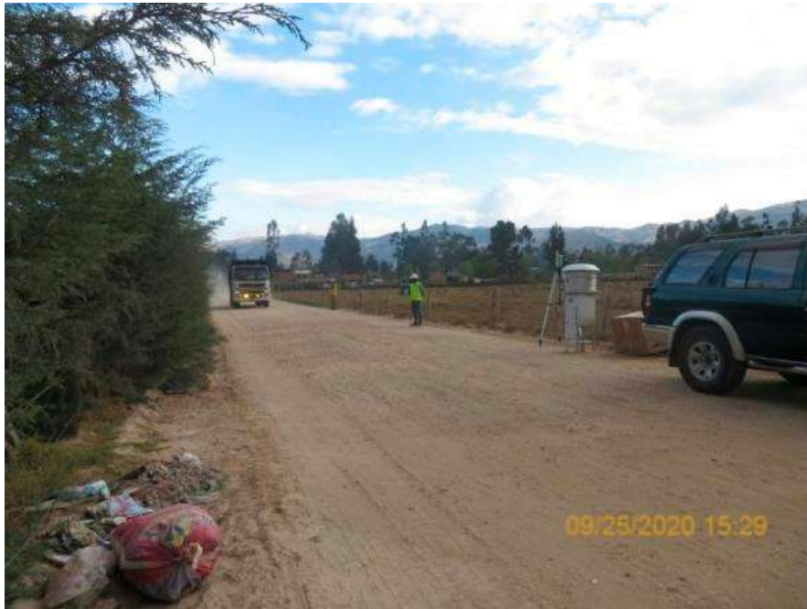
Imagen 5. Nivel de polvo sin agua.
