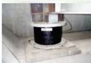
Aisladores en el Long Beach 911 Center no requiere protección contra el fuego.
