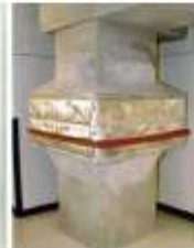
Se utilizaron mantas ignífugas en el Channing House
