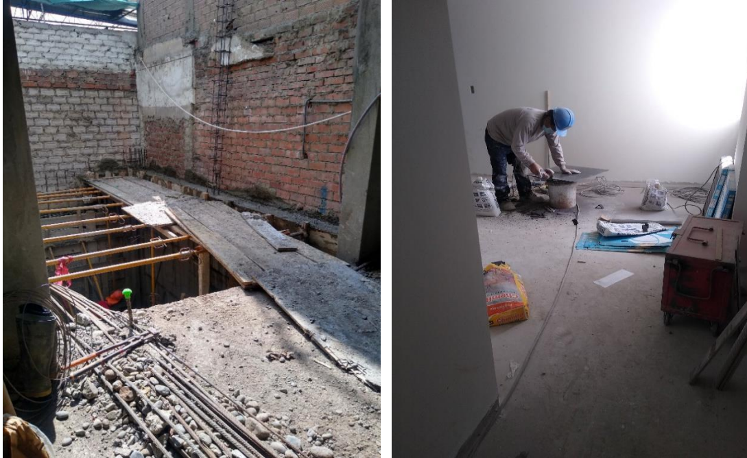
Figura 5. Inspección de obra 016- 2020. Se evidencia vano sin protección Colectiva y se verifica Personal Obrero sin Elementos de protección personal (guantes y lentes).
