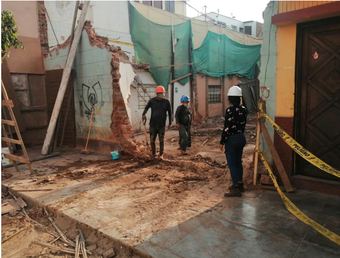
Figura 11. Inspección de una obra sin Autorización para uso de la vía pública
