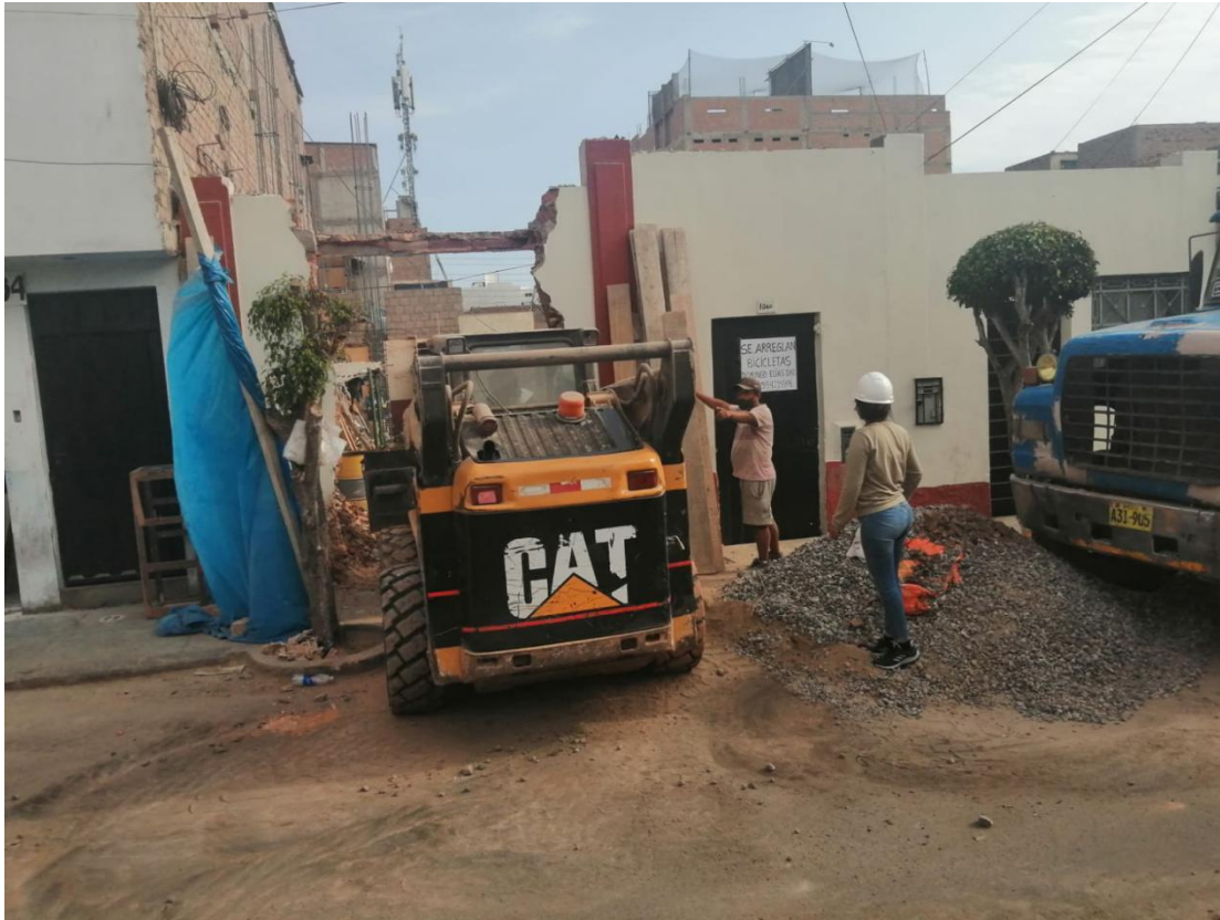
Figura 14. Inspección en obra con personal obrero en riesgo
