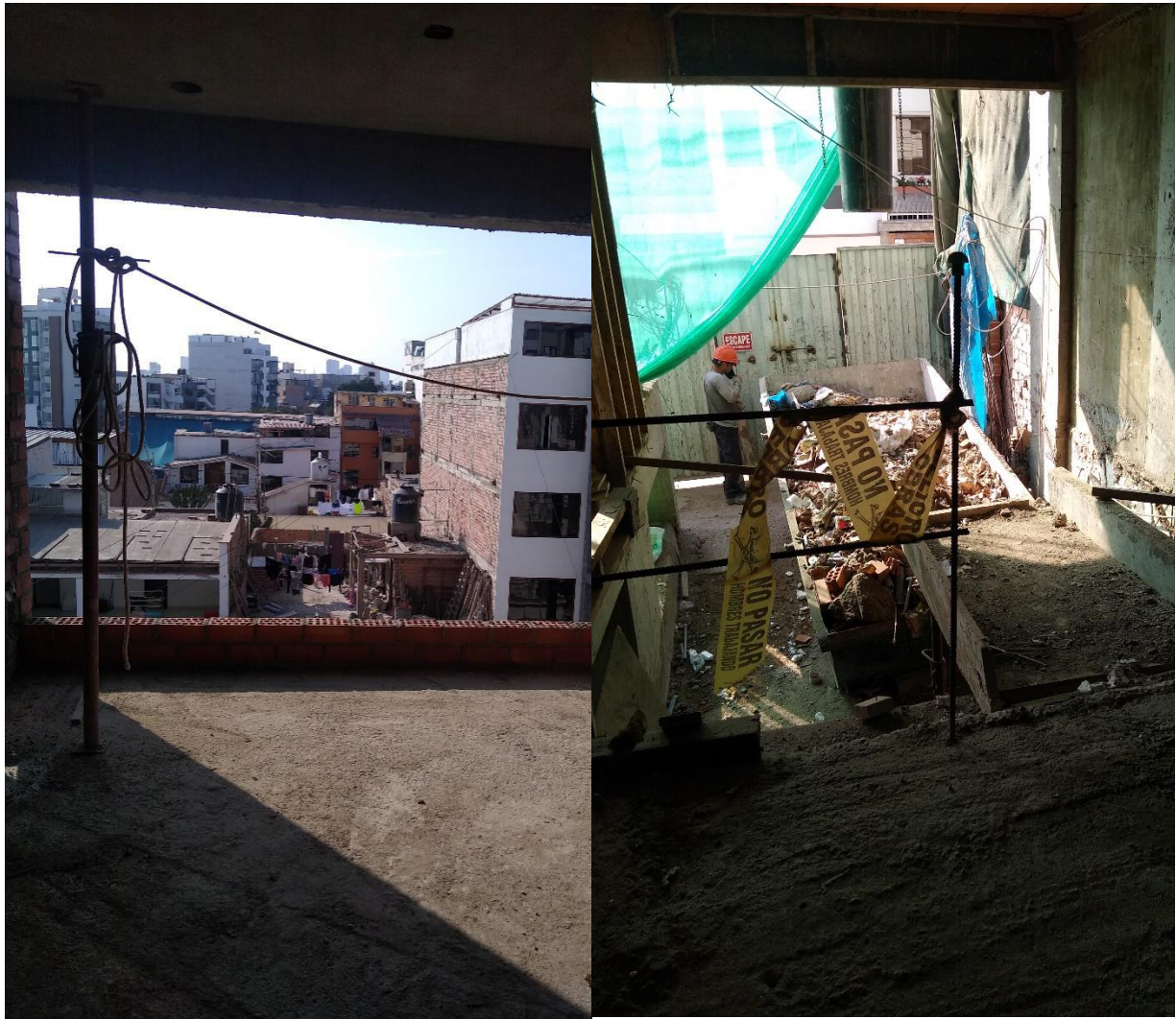
Figura 7. Inspección de obra 019- 2020. Vano sin protección colectiva y protección colectiva antirreglamentaria
