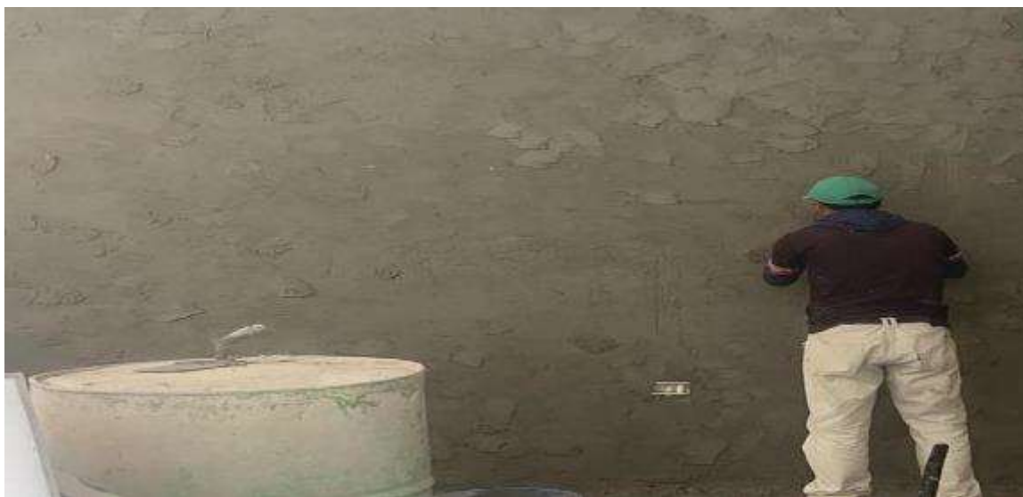
Figura 19. Se observa la colocación de mezcla en muro de interiores – Vivienda N° 02
