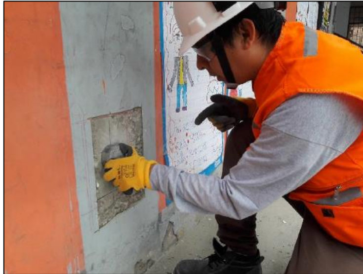
Figura 15: Proceso de Pulido y Limpieza en la zona libre de incidencia de varillas o estribos con la piedra abrasiva (preparación de superficie)
