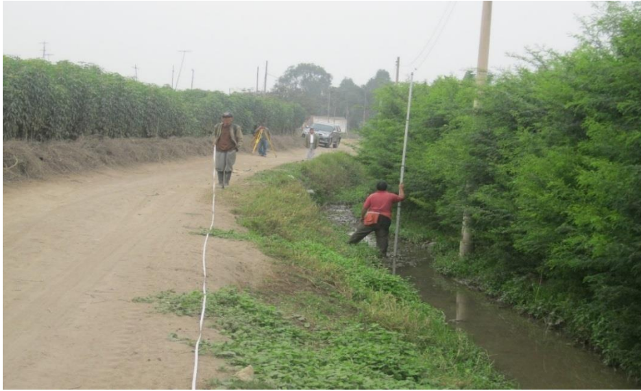
Figura 33: Levantamiento topográfico del Canal Rústico de Santa Elena Fuente: Junta de Usuarios Chancay - Huaral
