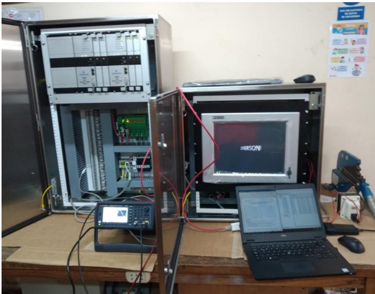
Figura 59. Comisionamiento de gabinetes. Fuente: Emerson Perú (2020)
