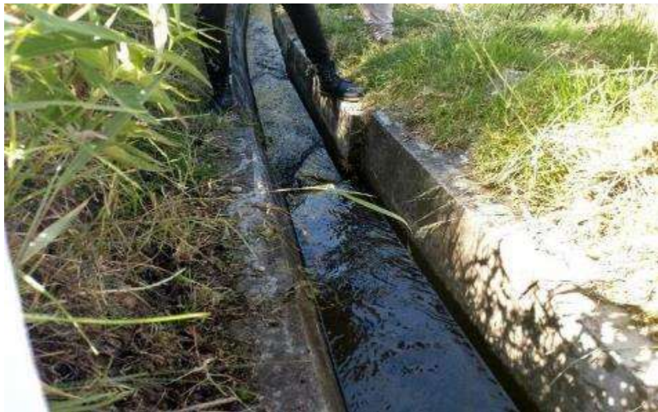
Figura 30. Canal de agua con fracturas. Fuente: Propia.
