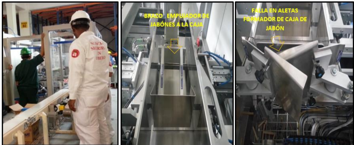
Figura 22. Falla de sensor en la máquina encajadora – encintadora
