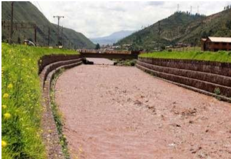
Fig N°00, Muro Gaviones, Fuente: Recuperación del Cauce del Río Provincias de Cusco y Quispicanchis – Región Cusco, Recuperado de http://www.promaingsa.com.pe
