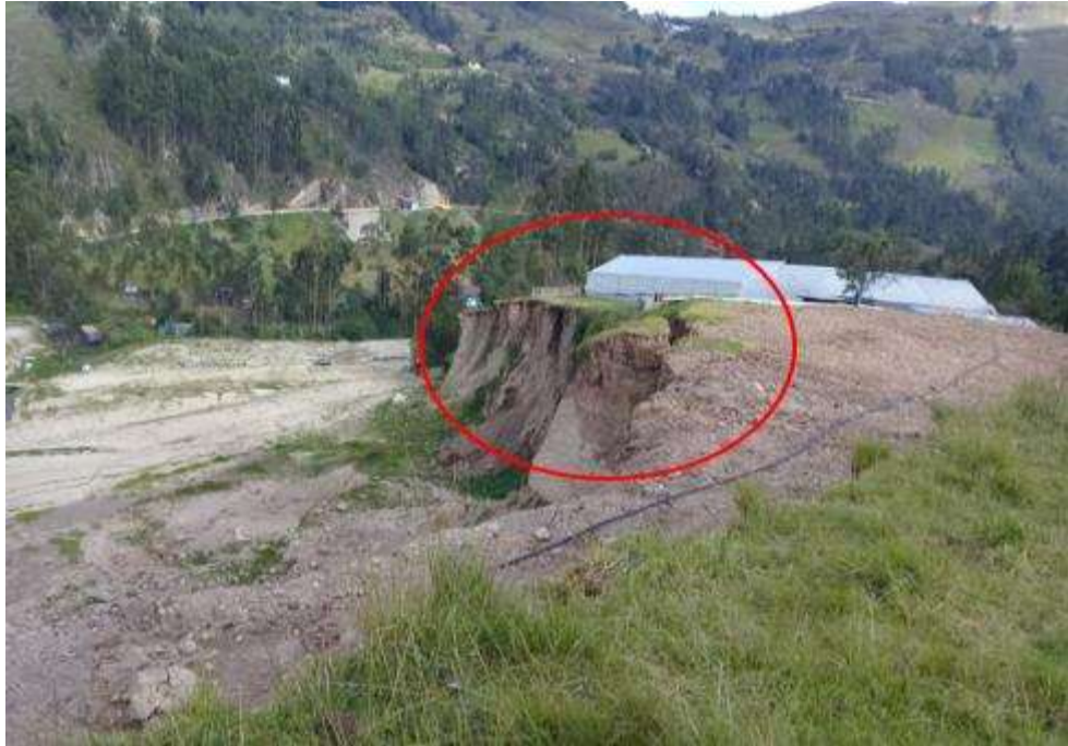
Figura B. N° 3: Posible deslizamiento de la zona de invernadero.
