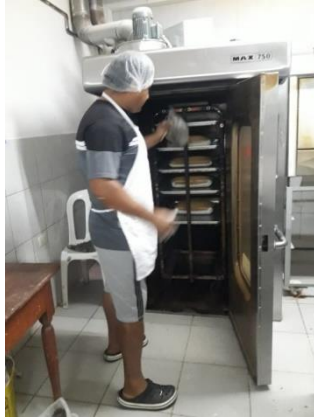
FIGURA 8 HORNO ELÉCTRICO DE LA CONFITERÍA LUBEN S.R.L..
