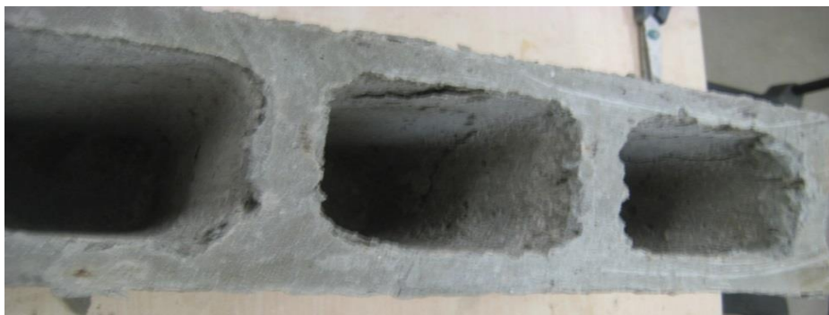
fotografía 38 Falla en el interior, bloque con CCA
