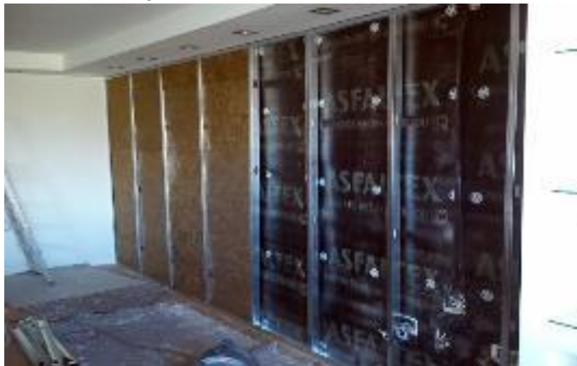
Figura N°4.28: Estructura – Paneles acústicos
