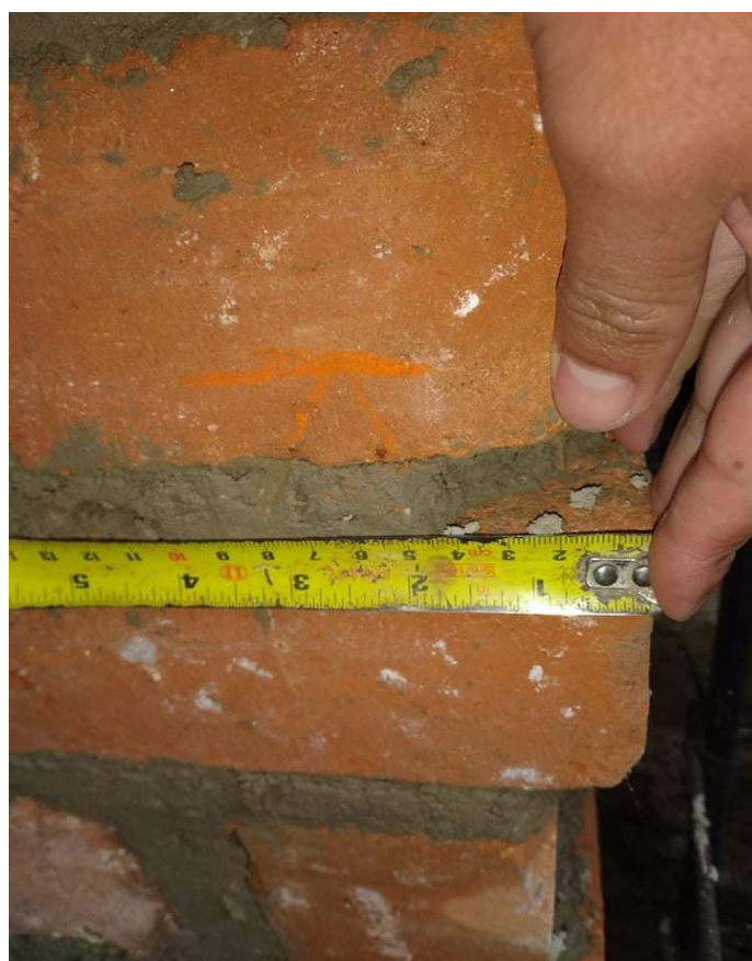
Figura 22. La saliente no excede los 5cm, columna- albañilería
