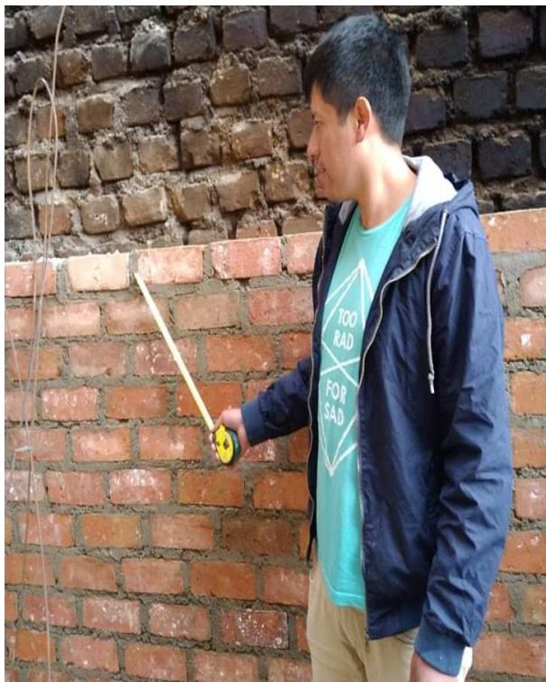
Figura 24. La primera jornada de trabajo se terminó llenando la última junta vertical de la hilada.
