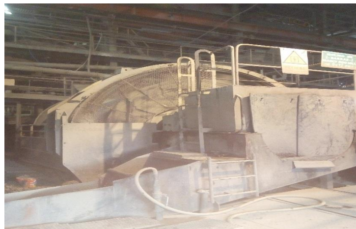
Figura 4. Molino Rodmill 2, Muestra el Molino de Barras Primario Allis Chalmers 9'x12' N° 2. Fuente: Elaboración propia.
