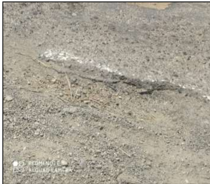
Figura 103: Grieta De Borde (Nivel Alto) – Carril Izquierdo
