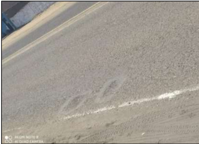
Figura 96: Desprendimiento De Agregado – Carril Izquierdo
