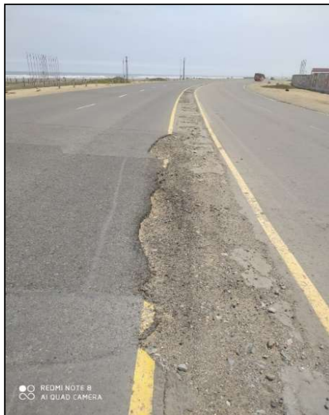
Figura 85: Grieta De Borde (Nivel Alto) – Carril Izquierdo
