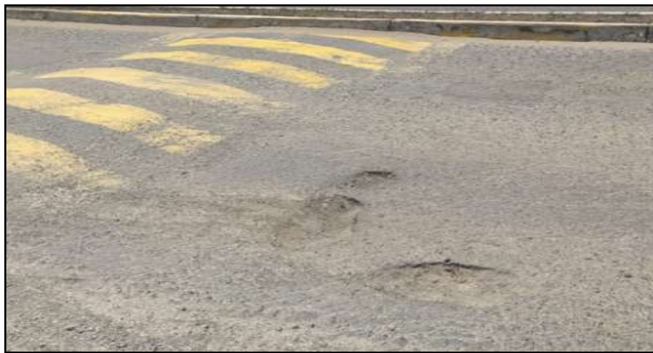
Figura 107: Desprendimiento De Agregado (Nivel Alto) – Carril Izquierdo
