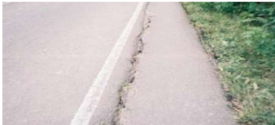
Desnivel de carril
