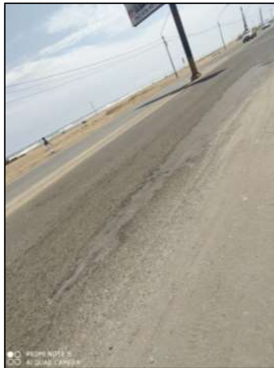
Figura 77: Falla Tipo Hueco (Nivel Medio)– Carril Derecho
