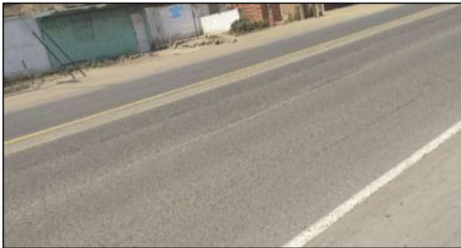
Figura 97: Ahuellamiento (Nivel Alto) – Carril Izquierdo
