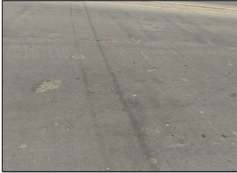
Figura 90: Corrugación (Nivel Bajo) – Carril Izquierdo
