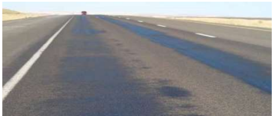
Falla de exudación
