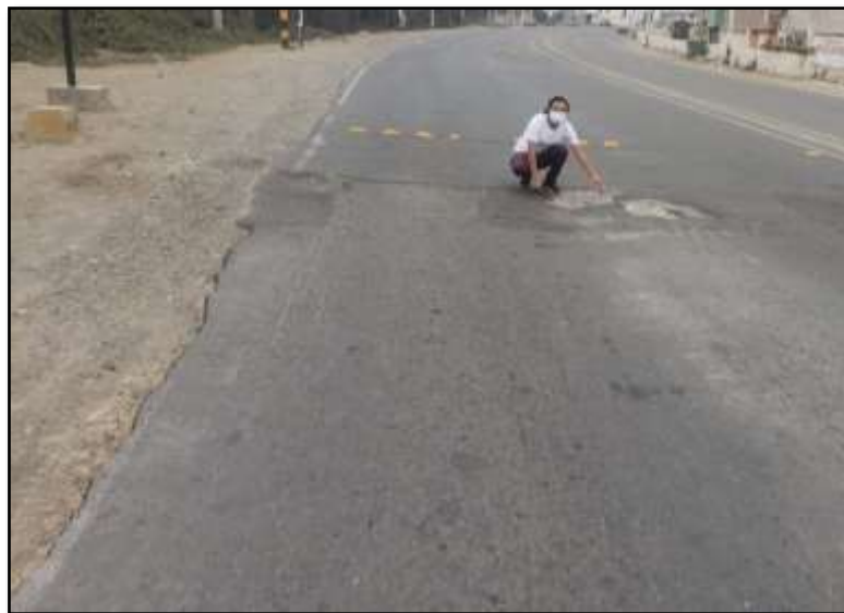
Figura 79: Falla Tipo Parcheo con Presencia de Huecos (Nivel Alto) – Calzada izquierda
