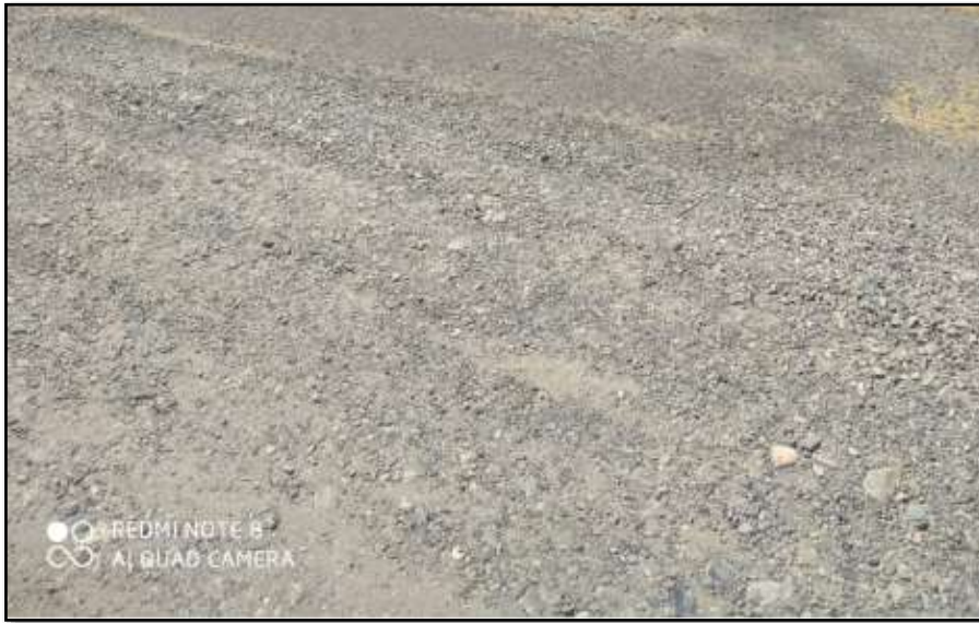
Figura 112: Desprendimiento De Agregado (Nivel Alto) – Carril Izquierdo
