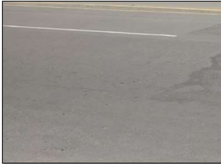
Figura 82: Grieta Longitudinal (Nivel Bajo) – Carril Izquierdo
