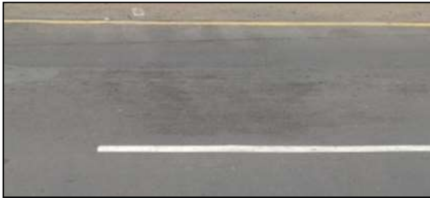
Figura 88: Desprendimiento De Agregado (Nivel Bajo) – Carril Izquierdo
