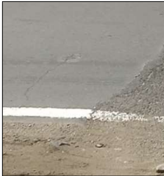
Figura 93: Grieta Transversal (Nivel Bajo) – Carril Izquierdo
