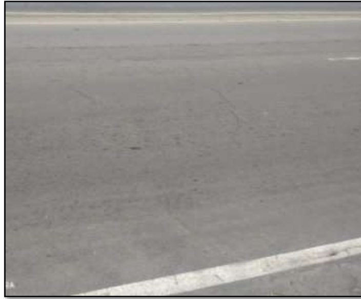
Figura 74: Falla Tipo Grieta Parabólica (Nivel Bajo) – Carril Derecho
