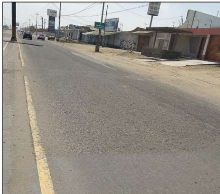
Figura 75: Falla Tipo Desprendimiento De Agregado (Nivel Alto) – Carril Derecho
