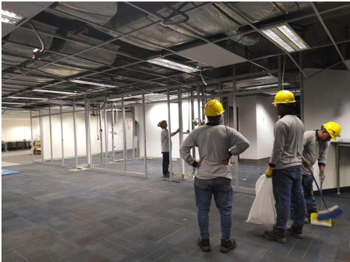
Imagen de una remodelación de oficinas para Movistar – Lima (fotografía propia de la empresa Inversiones & Contratistas ZAYD SAC)
