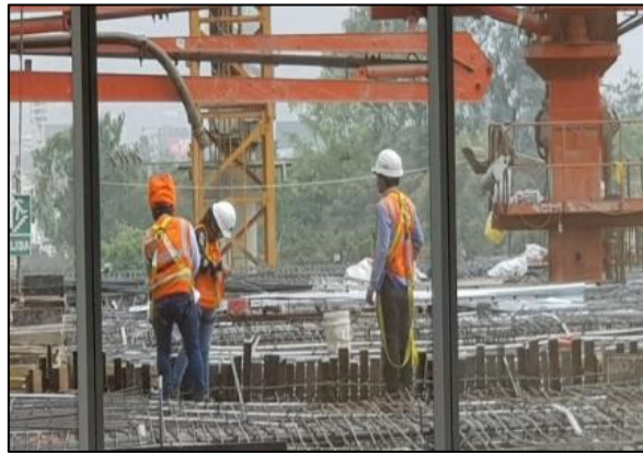
Figura 122. Liberación de acero con supervisor de calidad Huanwil y supervisor JLV Consultores, proyecto More Golf Los Incas.
