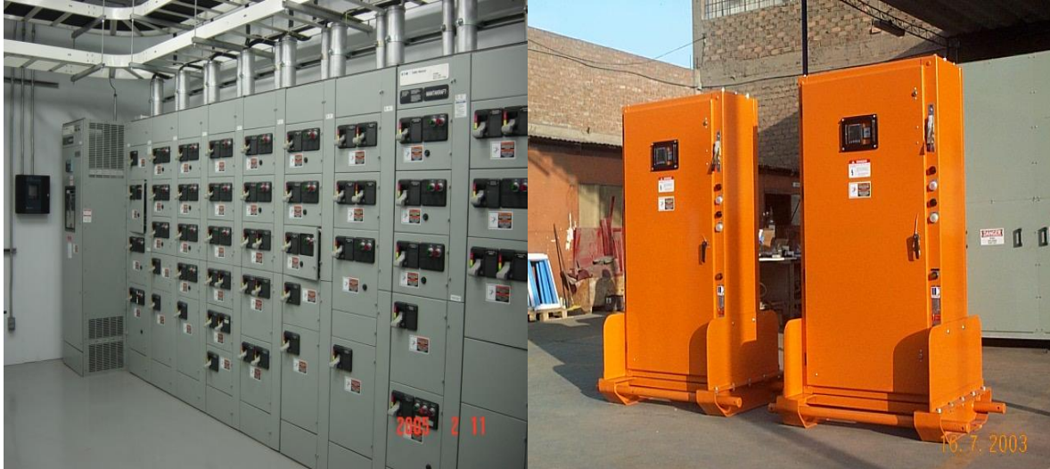
Figura 3. Centro de control de motores y tableros eléctricos underground instalados por la empresa. Fuente: DIMATIC SAC (2020)
