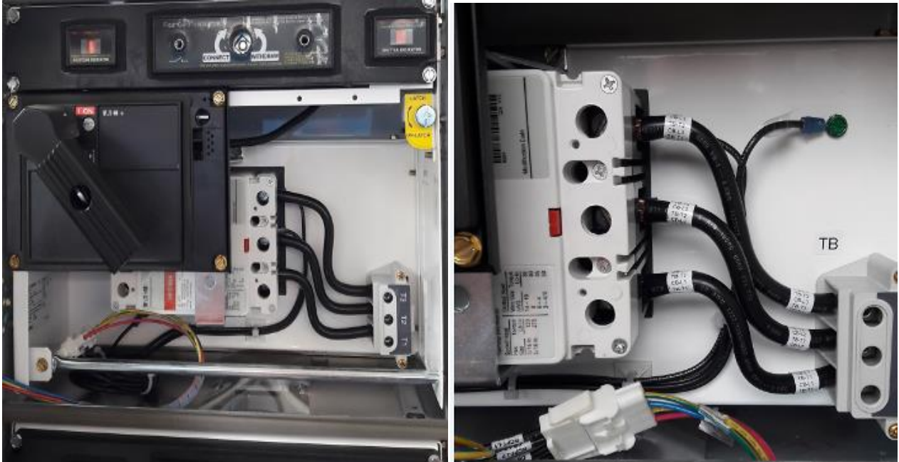
Figura 18. Cableado y conexión de equipos
