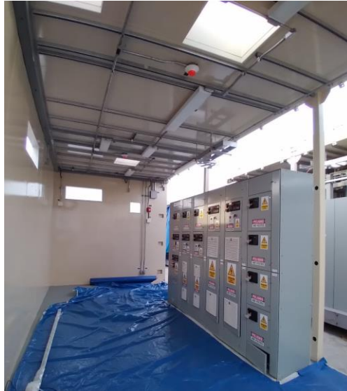
Figura 23. Señalética de equipos
