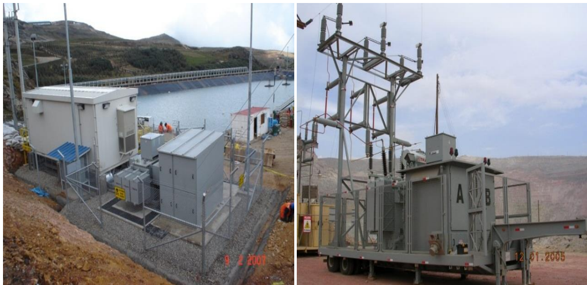
Figura 2. Salas eléctricas y subestaciones móviles instaladas por la empresa. Fuente: DIMATIC SAC (2020)
