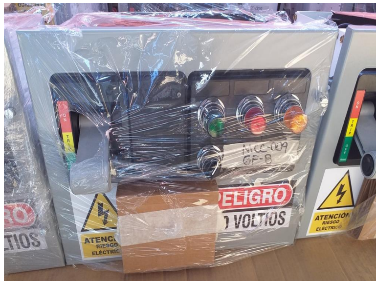
Figura 22. Señalética de equipos
