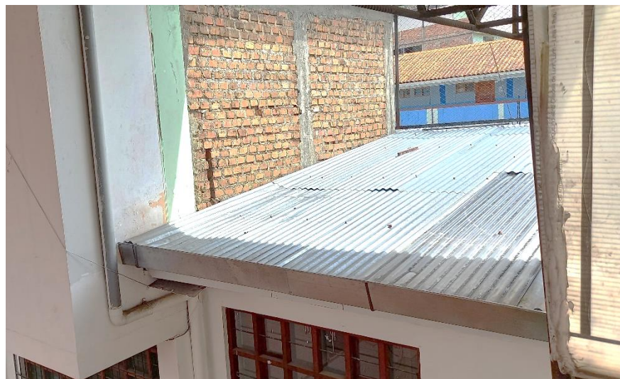
Figura 31. Cubierta del pabellón A, con calamina y estructura de metal Fuente: Elaborada por los autores
