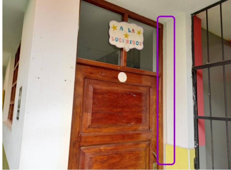
Figura 35. Junta sísmica entre el pabellón B y C inexistente Fuente: Elaborada por los autores
