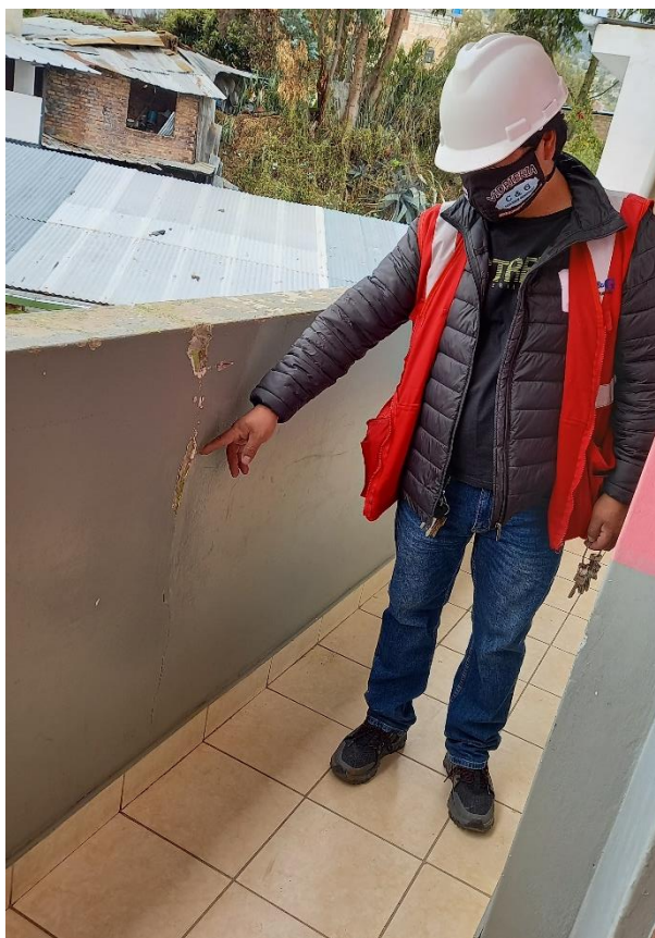
Figura 10. Fisura en parapeto del pabellón B de la IE N° 055. Fuente: Elaborada por los autores
