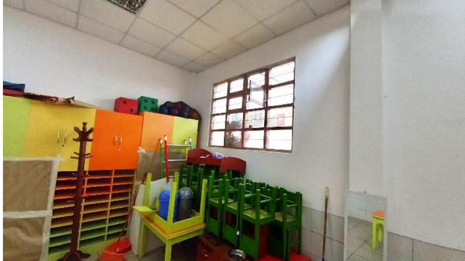
Figura 14. Muro portante no presenta amarre con viga en el pabellón A. Fuente: Elaborada por los autores.
