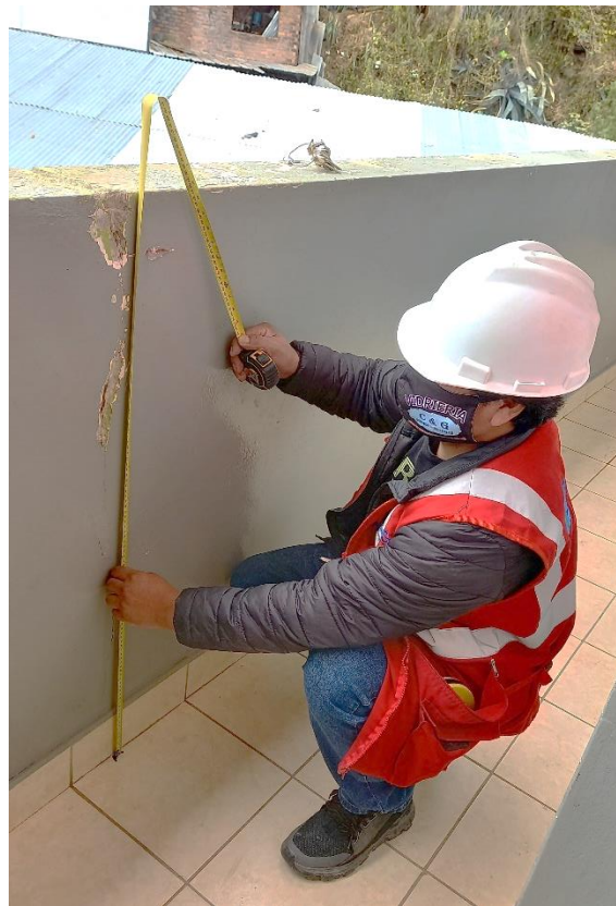
Figura 36. Fisura en parapeto del pabellón B Fuente: Elaborada por los autores
