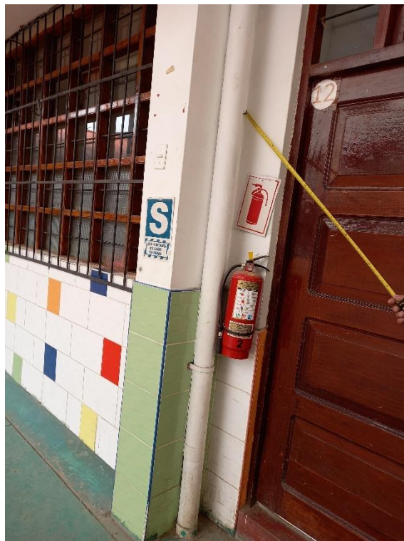
Figura 34. Junta sísmica entre el pabellón A y B inexistente Fuente: Elaborada por los autores
