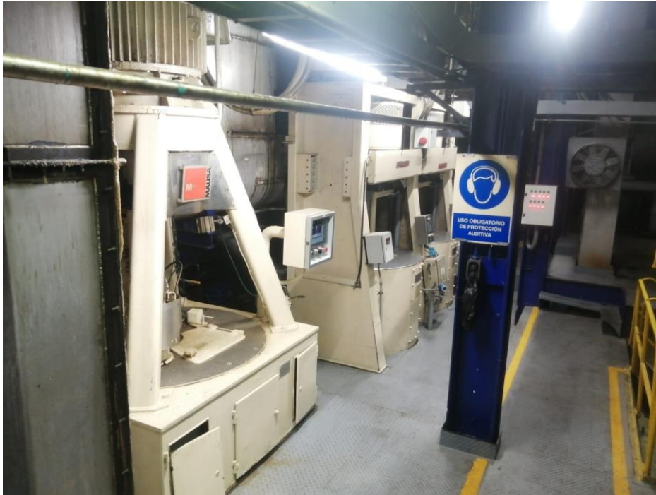
Figura 10: Batería de Centrifugas Bach para masa primera.
