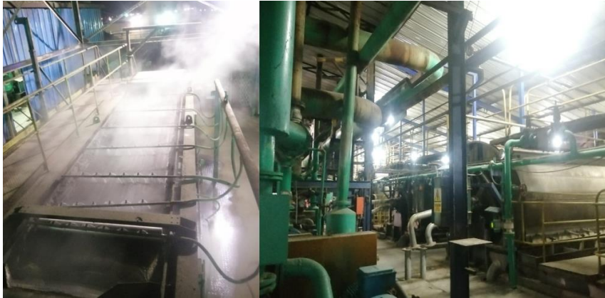
Figura 6: Sistemas de filtración de lodos de cachaza.
