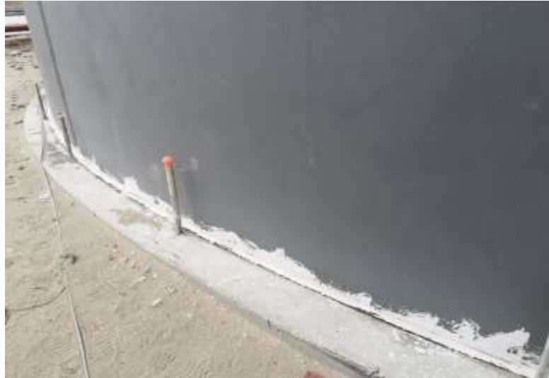
Figura 45. Prueba de diésel en caliente
