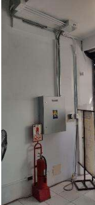
Suministro e Instalación de Tablero Eléctrico
