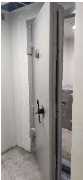
Pintado de Puerta Bóveda (Acabado Martillado) – Colocación de Chapa, Manija y Configuración de Sistema de Seguridad
