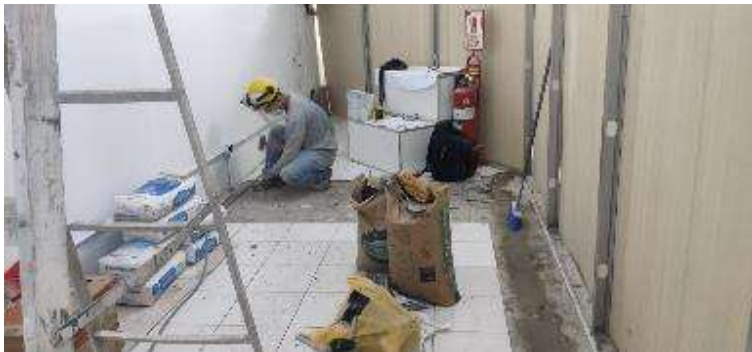
Trabajos de Entubados PVC para Instalaciones Eléctricas en Piso y Resanes con Mortero
