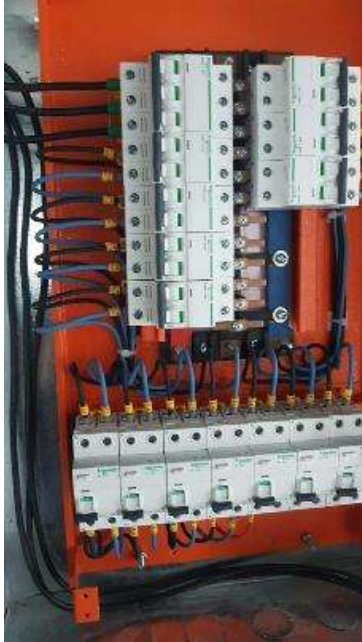
Suministro e Instalación de Tablero Eléctrico
