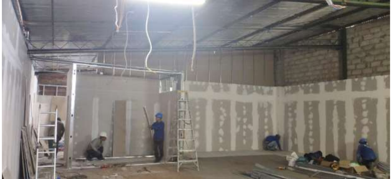
Entubado EMT Conduit para Puntos de Iluminación
