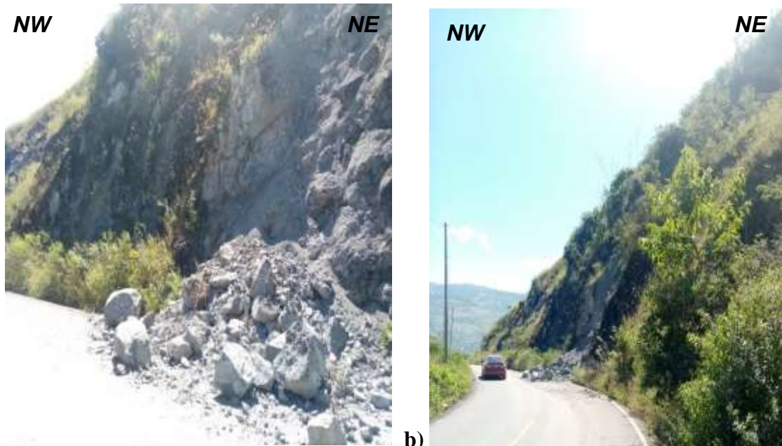
a) Se observa una caída de rocas de gran tamaño en la carretera principal b) Se muestra la caída de rocas que ha ocupado un carril de la pista que son un peligro latente para los conductores. FUENTE: Propia (2021).
