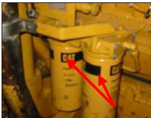
Figura 42. Filtros de combustible.
