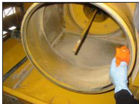
Figura 14. Parte interna del filtro primero.
