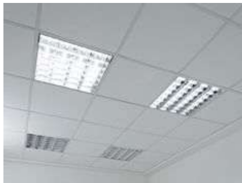
Figura 67: Iluminación empotrada en falso cielo raso
