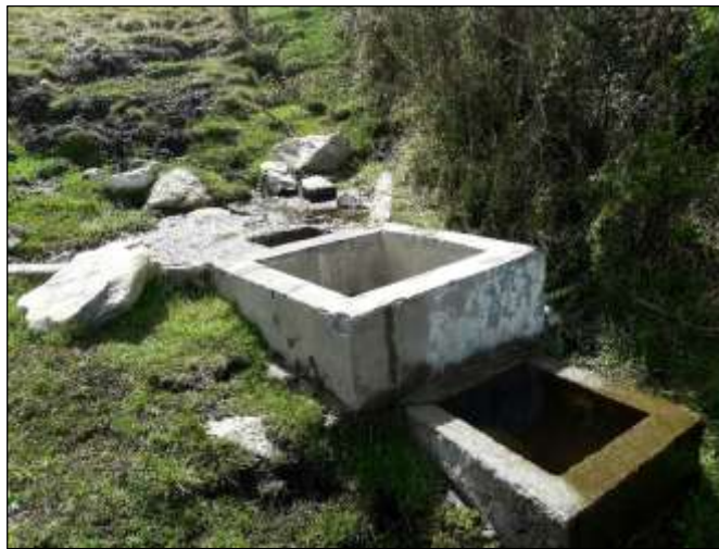
Figura 16. Captaciones colapsadas, sector de Nahuinhuaylla
