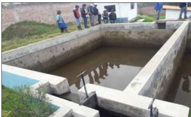
Figura 25. Situación actual del filtro lento.
