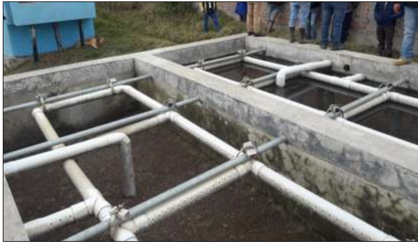
Figura 24. Situación actual del pre filtro
