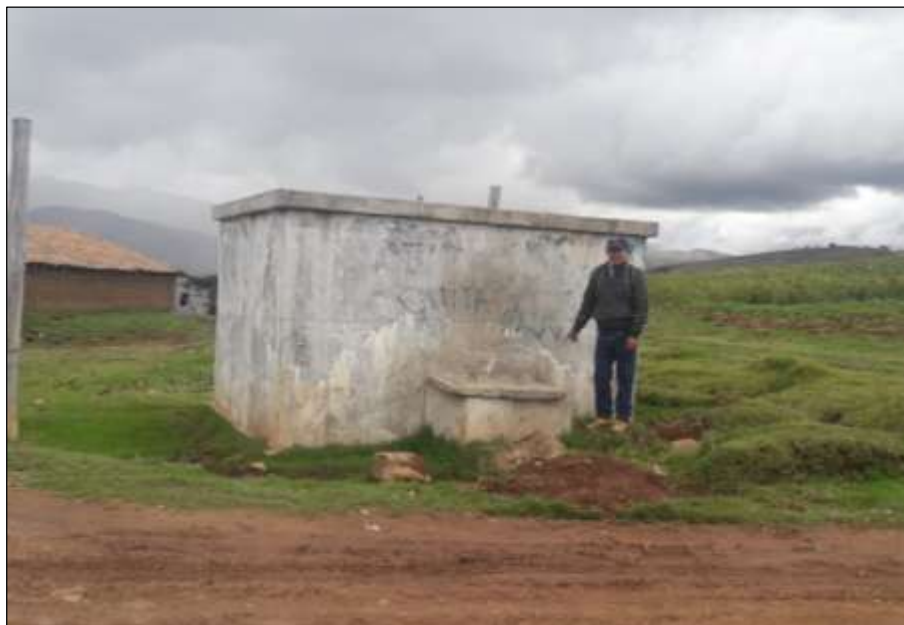
Figura 19. Situación actual del reservorio de almacenamiento.
