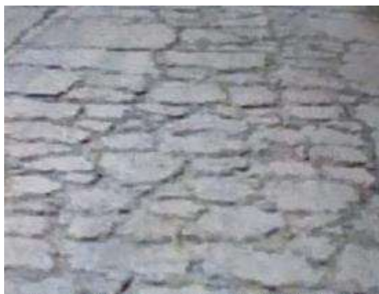
Escamadura de severidad alta
