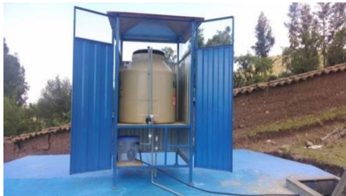
Figura 3. Caseta de cloración con estructura metálica, volumen tanque de 600 L.
