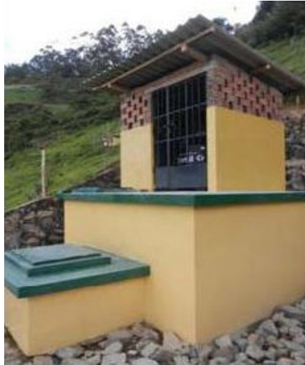
Figura 2. Caseta de cloración de material noble.
