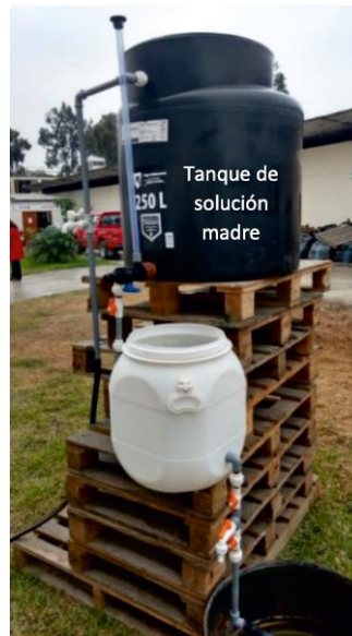
Figura 9. Tanque de polietileno con recipiente dosificador.
