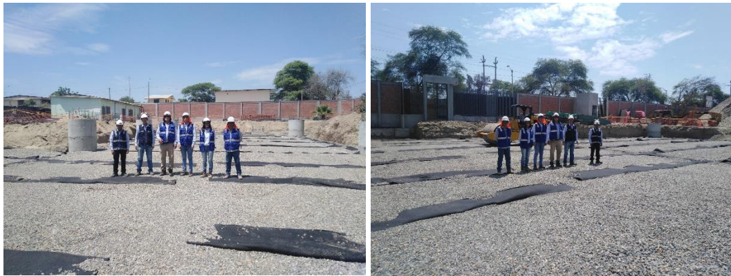
Figura 61: Relleno con piedra chancada de \frac{1}{2} " a \frac{3}{4} " hasta el nivel de -1.88 mt.,
