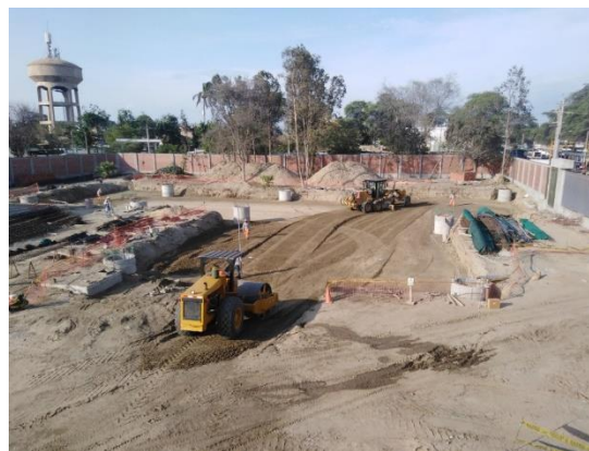
Figura 66: Nivelación y compactado de relleno con material de préstamo y control de nivel topográfico
