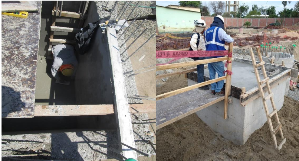
Figura 43: Acabado, encofrado, acero y vaciado de losa maciza de cuarto de máquinas
