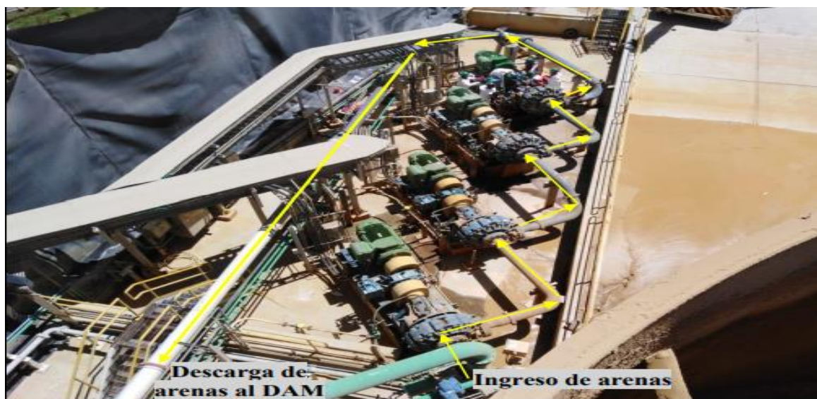
Figura 3. Tren de bombas
