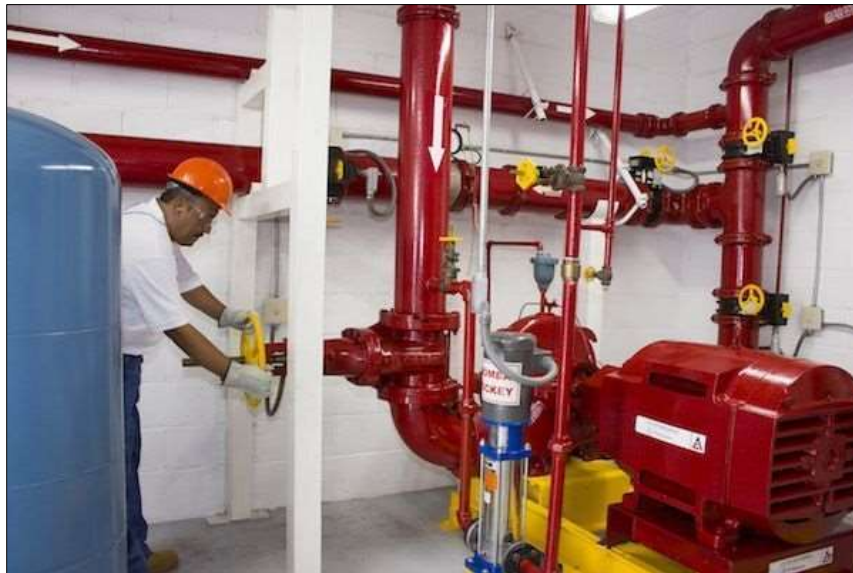
Figura 56: Instalación de Agua Contra Incendio.
