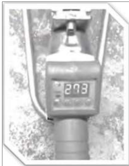
Figura 29: Temperatura de la Máquina Termofusora.
