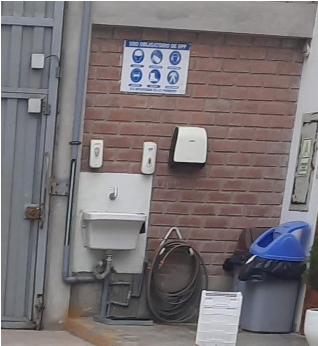
Anexo N. Estación de desinfección entrada de las instalaciones
