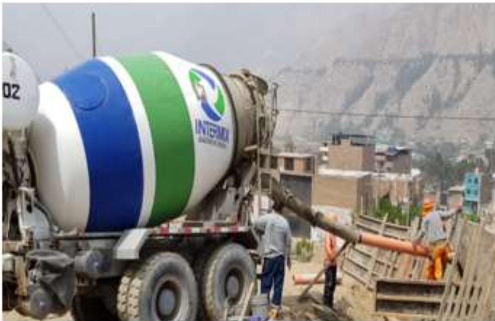
Figura 10. Construcción de Muros en el Barrio Casa Huerta del Distrito de Santa Eulalia
