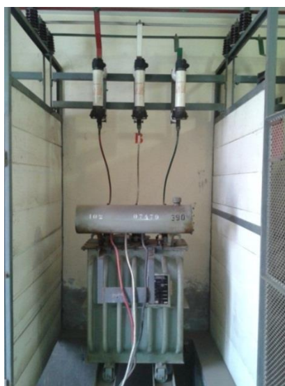
Figura 7. Transformador de media tensión
