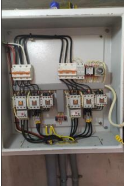
Figura 29 - Tablero de electrobombas
