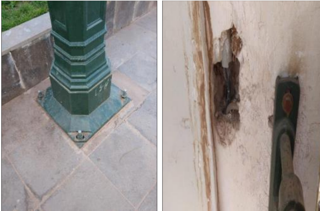
Figura 30 - Poste con pernos a la intemperie y sujeción de braquet en muros
