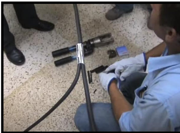
Figura 187. Empalme de derivación en baja tensión. Nota: Bueno (2008).
