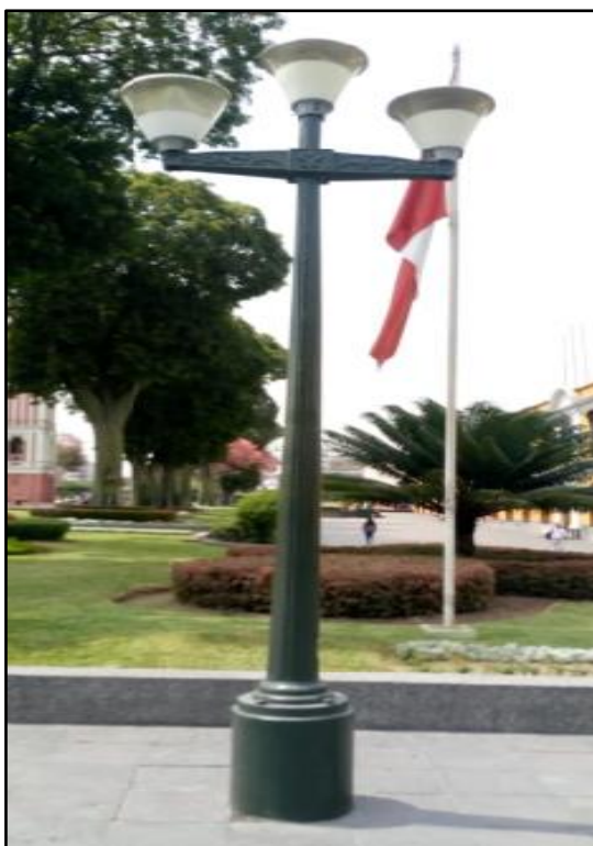
Figura 83. Vista de poste ornamental.
