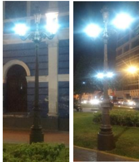
Farolas con luminarias quemadas.
