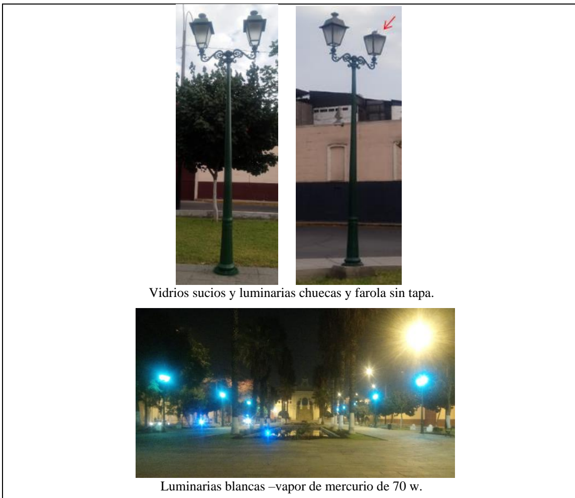
Figura 136. Vista diurna y nocturna de los sistemas de electrificación en el Paseo de Aguas.
