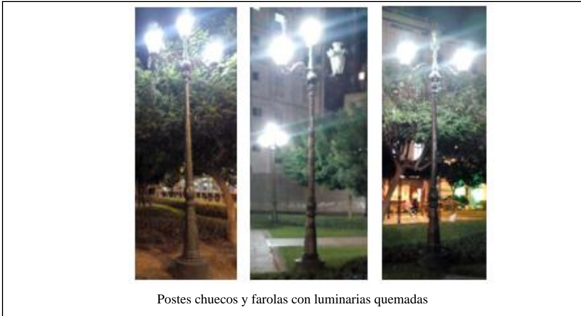
Figura 105. Vista nocturna de los sistemas de electrificación en la Plaza la Democracia.
