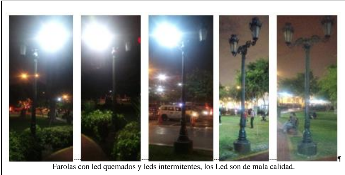
Figura 117. Vista nocturna de los sistemas de electrificación en el parque Juana Alarco de Dammert.
