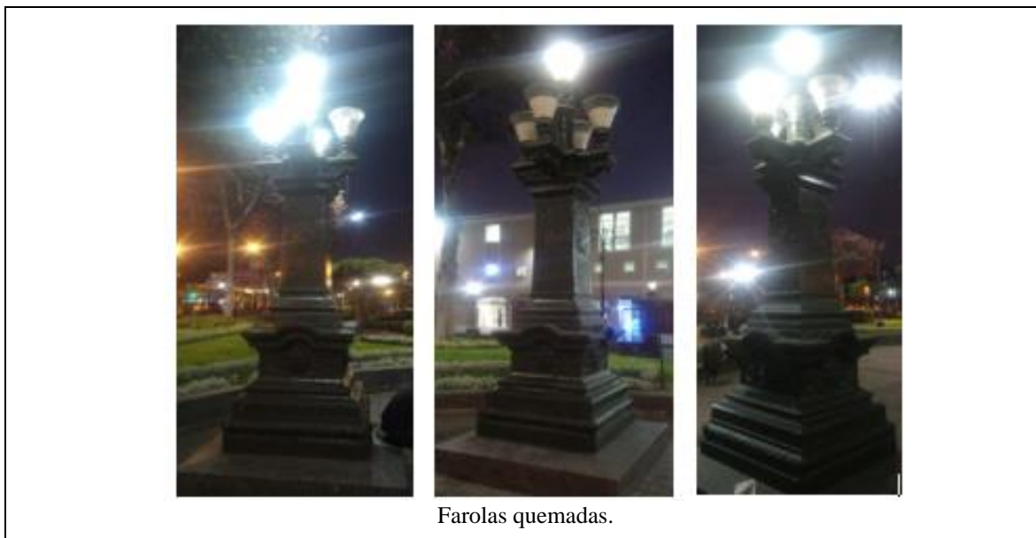
Figura 112. Vista nocturna de los sistemas de electrificación del sector 1 del Parque Universitario.
