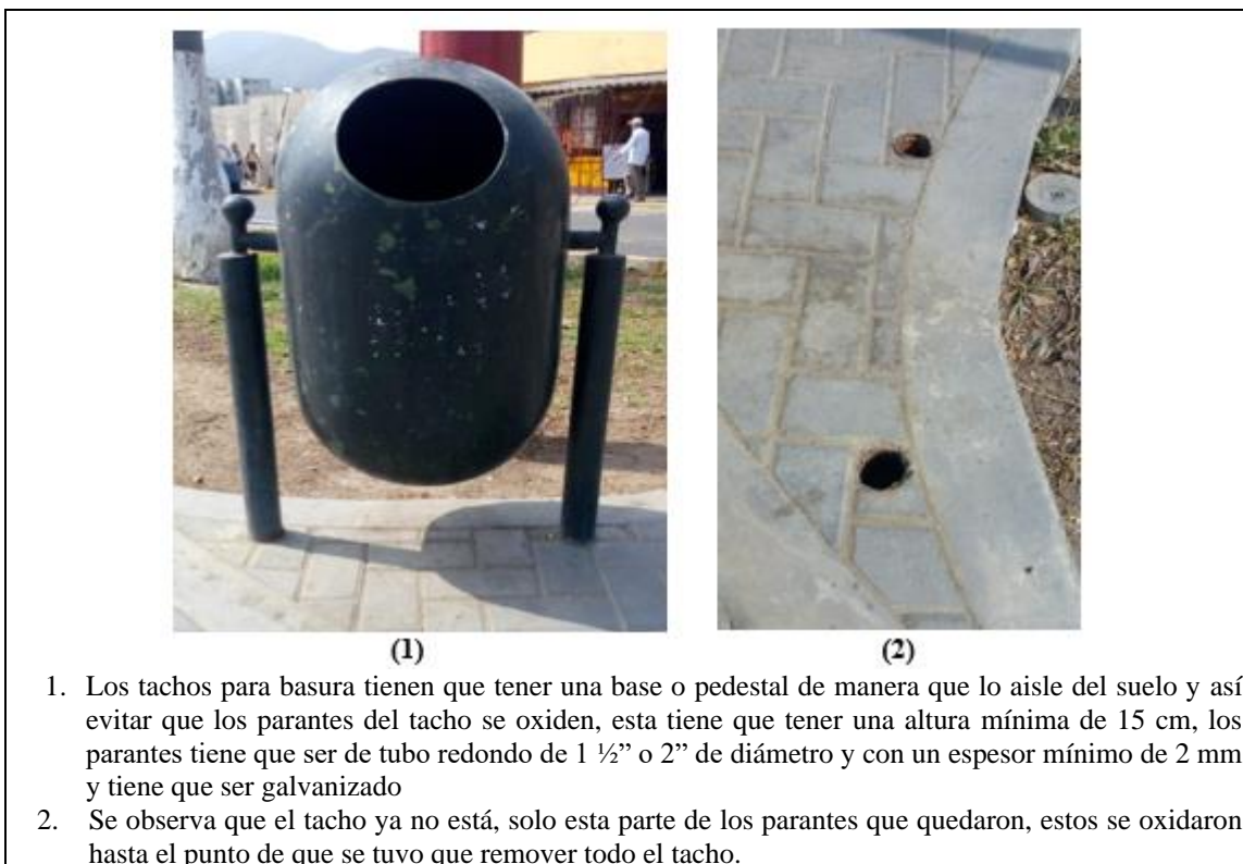
Figura 68. Evaluación de mobiliario urbano (tachos) en Plaza Juana de Alameda de los Bobos.
