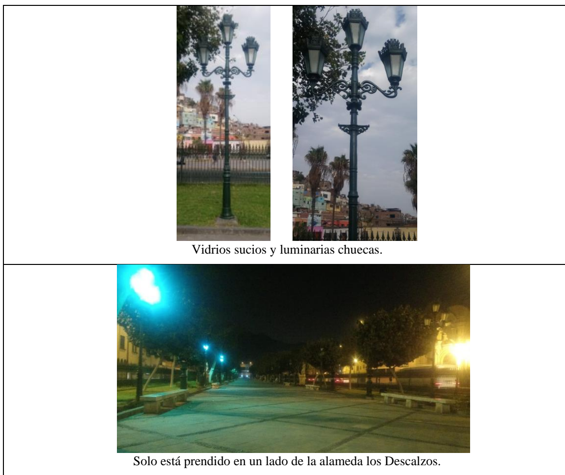
Figura 133. Vista diurna y nocturna de los sistemas de electrificación en la alameda Los Descalzos.
