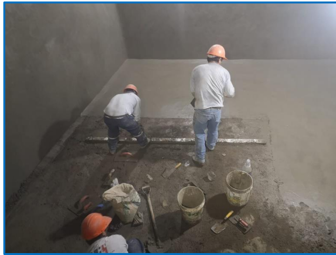
Figura 144. Tarrajeo pulido impermeabilizado en cisterna de agua contra incendio y cisterna de consumo doméstico.
