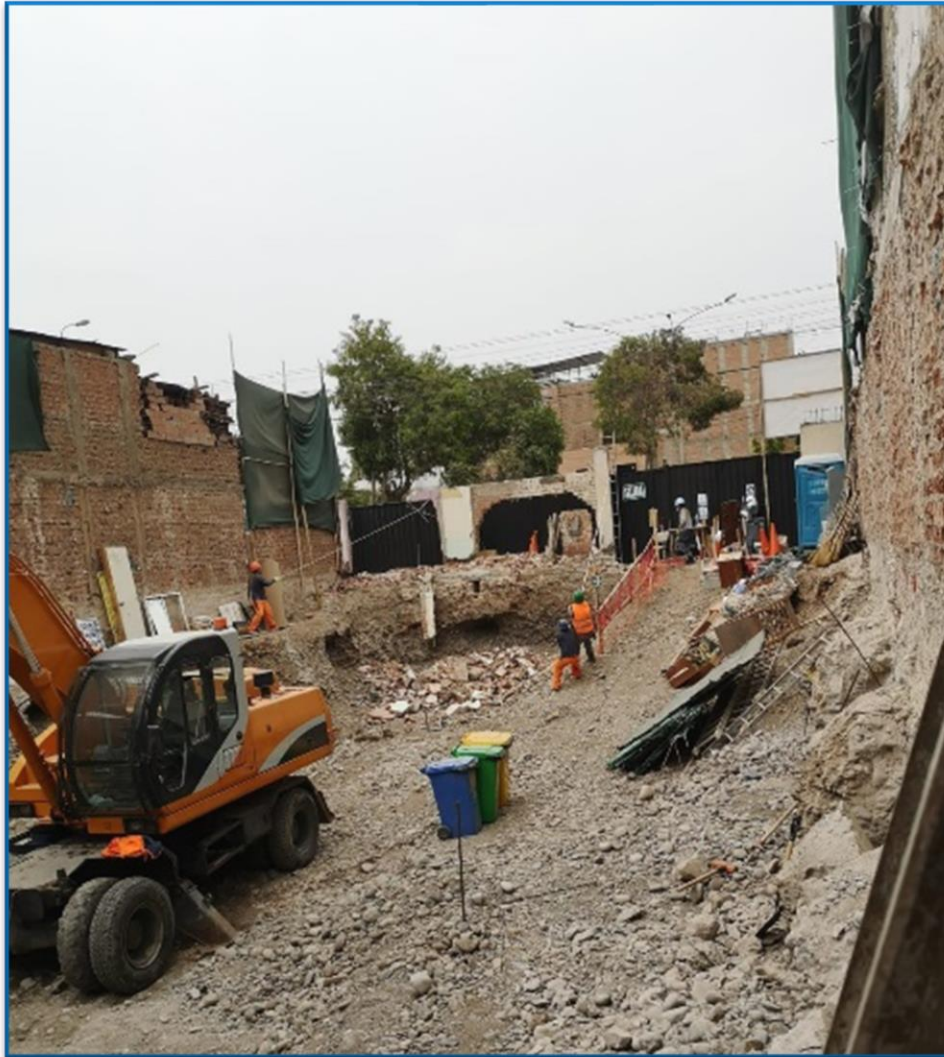
Figura 133. Inicio del proyecto multifamiliar Jana, limpieza de terreno, demolición y excavación masiva del primer anillo de los muros anclados.
