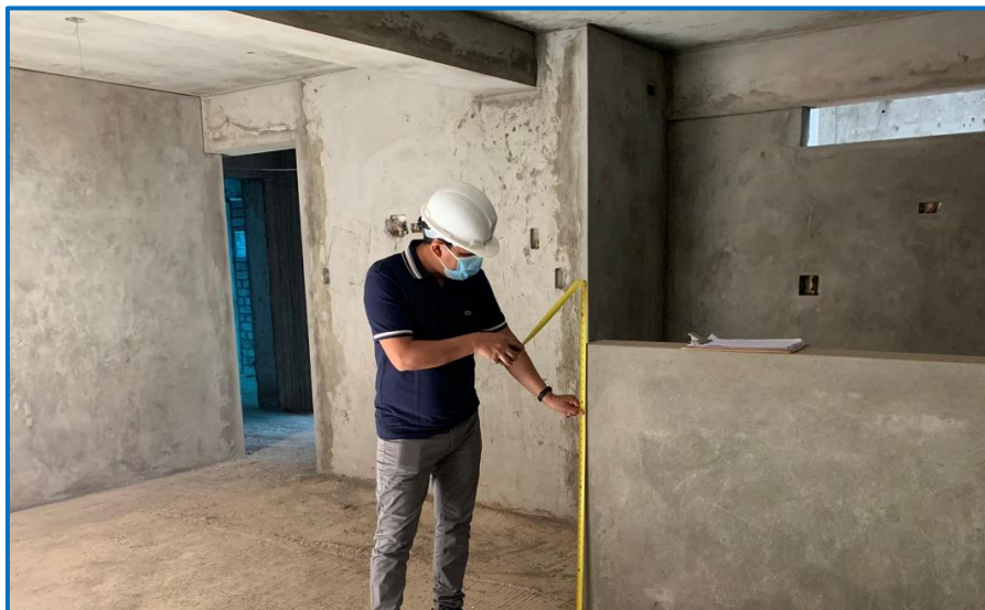
Figura 151. Tarrajeo en muros interiores, losas aligeradas, vigas peraltadas, verificación y control de calidad en las dimensiones de vanos y alfeizar en campo.
