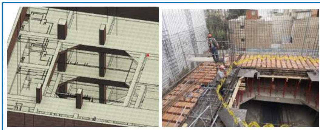
Figura 141. Modelo 3D y la colocación de barandas de seguridad, colocación de acero en placas, columnas, vigas peraltadas, vigas chatas y losas.
