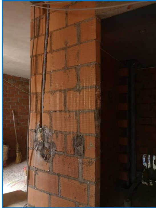
Figura 146. Inicio de la etapa de albañilería, instalaciones de tomacorrientes e interruptores y colocación de mallas electrosoldadas de refuerzo.
