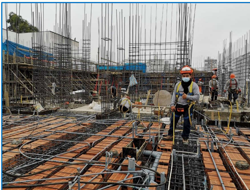
Figura 143. Supervisión de la cuantía de acero, verificación en instalaciones de agua, desagüe, eléctricas, colocación de ladrillos y encofrado de losa en el sector 2.
