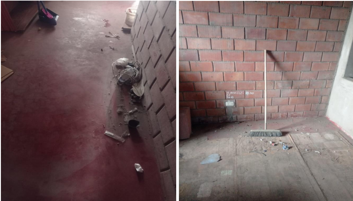
Figura 42. Área y piso de almacén sucio.
