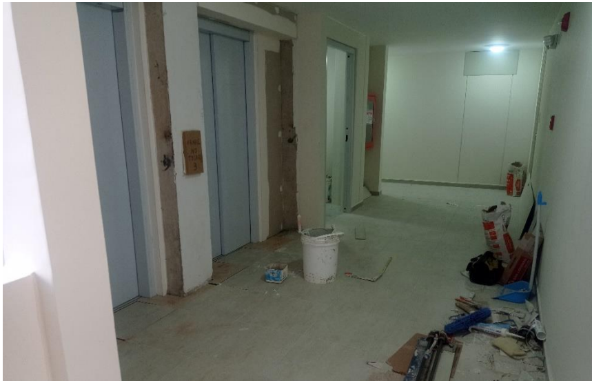
Figura 44. Área de trabajo en campo sucio y desordenado antes de iniciar los trabajos.
