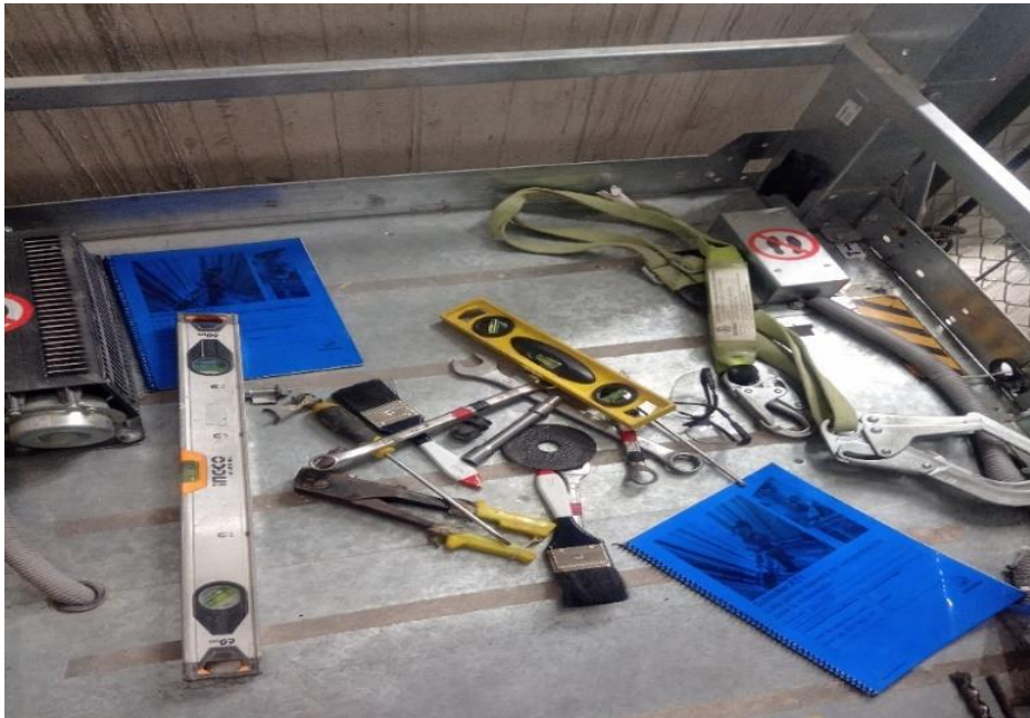
Figura 40. Desorden en techo de cabina del ascensor.
