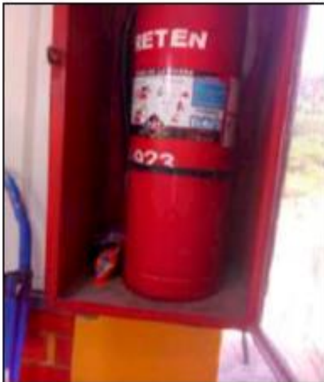
Extintores sin protección, usan como almacén los gabinetes
