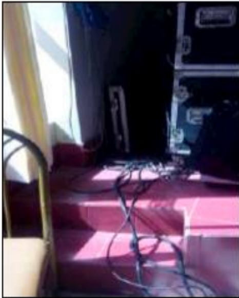
Escenario Musical: Cableado expuesto
