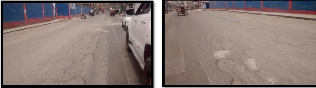
Figura 25: Pavimento flexible con presencia de baches.
