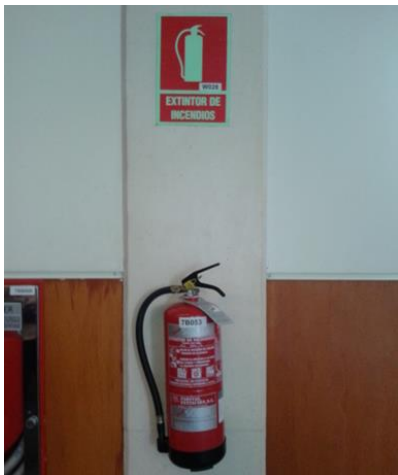
Figura 29. Señalización para extintores.
