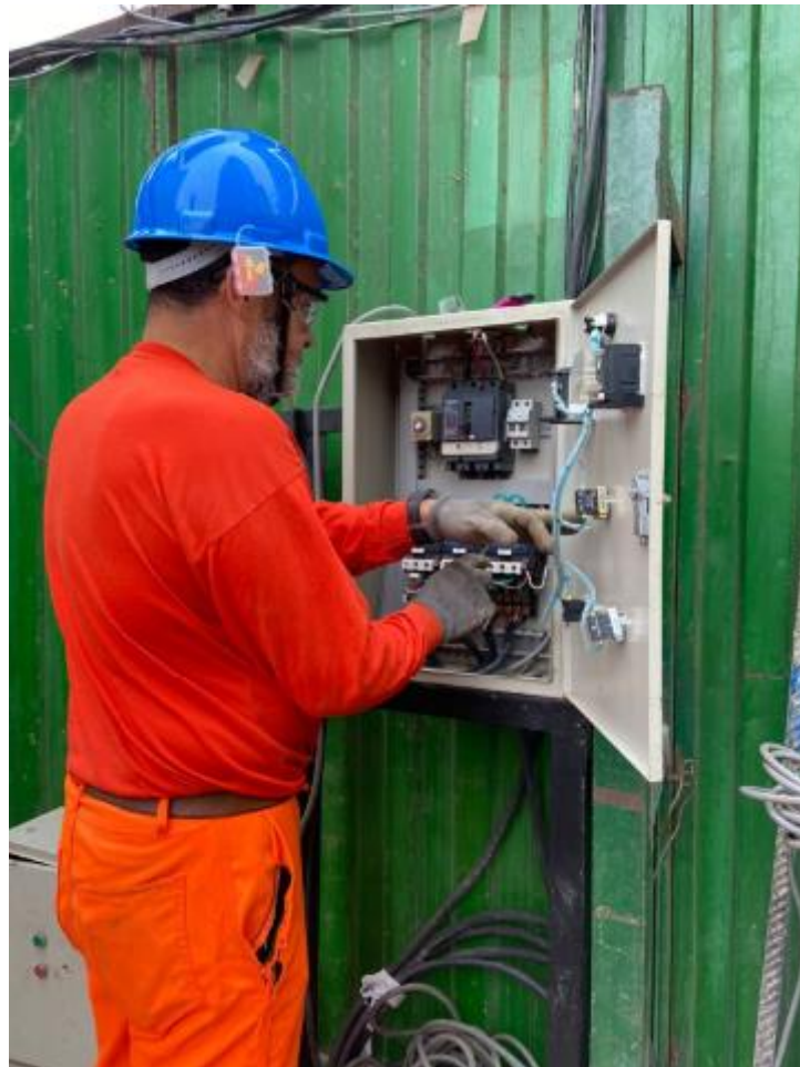
Figura 34. Instalación de tablero eléctrico
