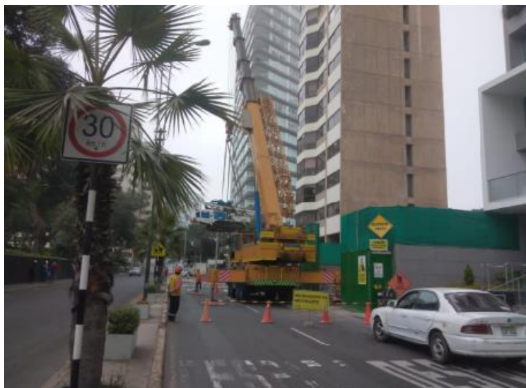
Figura 44. Izaje de equipos de inyección
