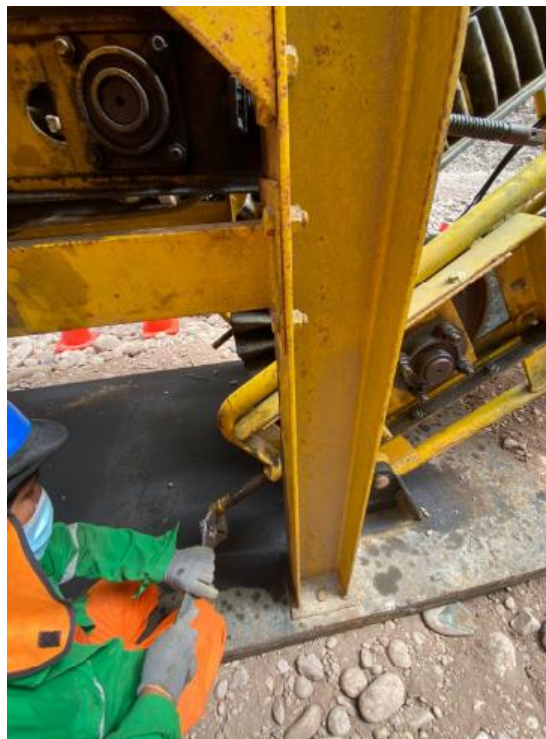
Figura 26. Tensado de faja de manera manual
