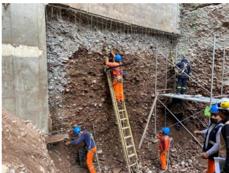
Figura 58. Desquinche de fondo de muro
