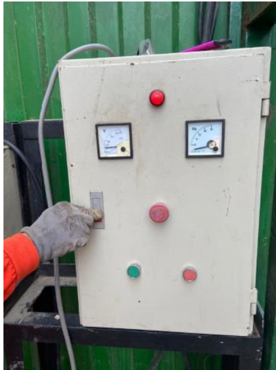
Figura 42. Tablero con botones de encendido y apagado de la faja
