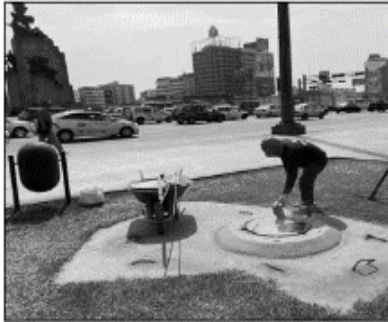
Buzon de arranque para toma de datos
