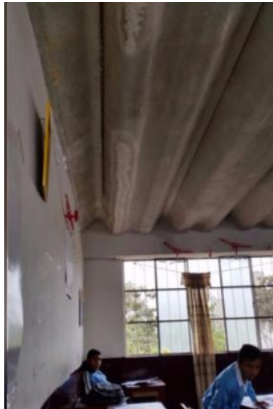
Vista interiores de salones en Chepén con techos prefabricados que generar “hornos de calor” dentro de ellos.
