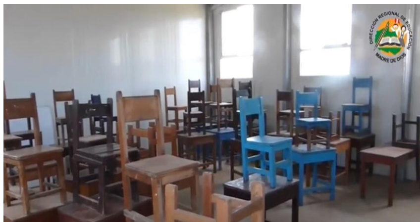
Vista interiores de salones con problema de ventilación en Escuela Guillermo Billinghurst en Madre de Dios.
