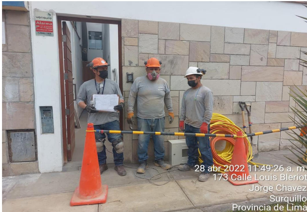
Figura 6: Redes Internas en el distrito de Surquillo.
