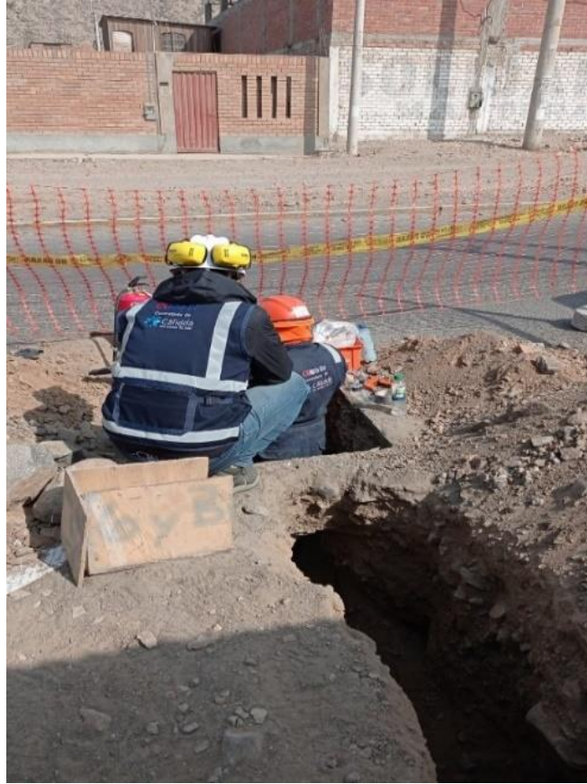
Figura 5: Tubería de conexión en el distrito de Carabayllo
