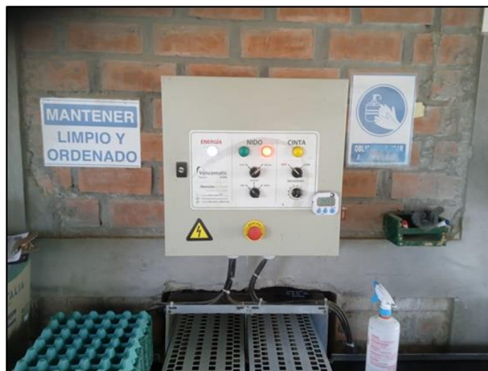
Figura 9: Tablero control cinta y nidos.
