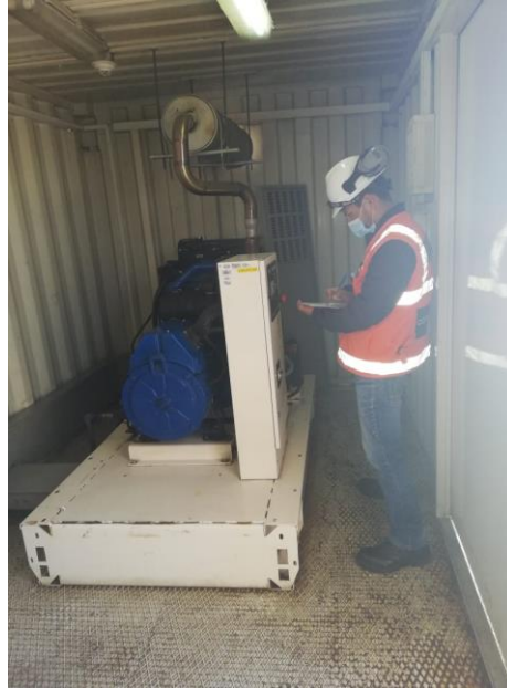
Figura 16 Aplicación de las 5'S en compresor
