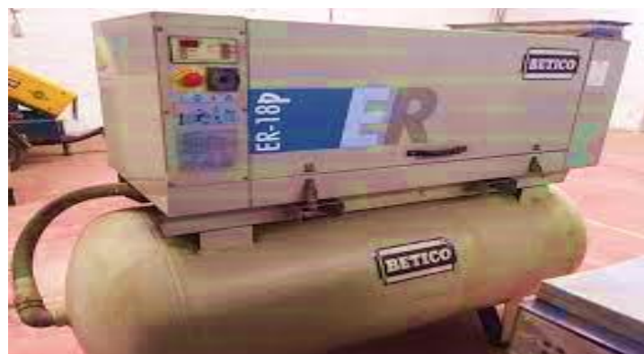
Figura 6 Compresor QD65Y del área de mantenimiento
