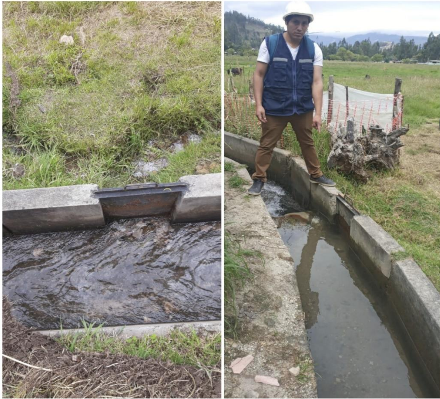
Cierre de compuertas del canal de riego tres molinos. KM-(00+000 AL 05+000)
