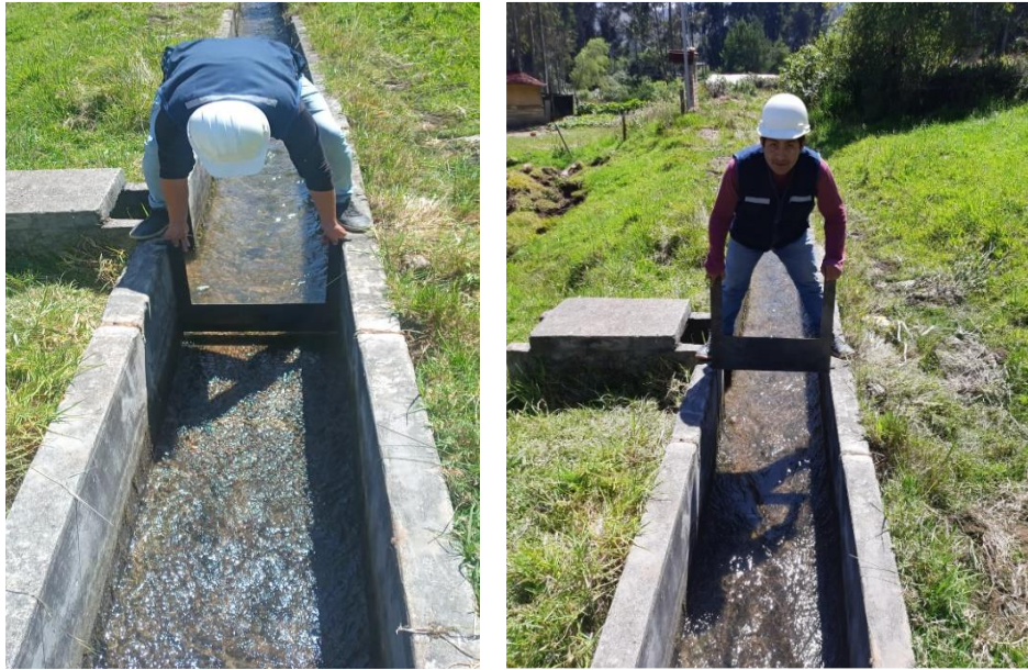
Ilustración 6, 7: Colocación de vertedero rectangular en la pestaña en el lugar de estudio.
